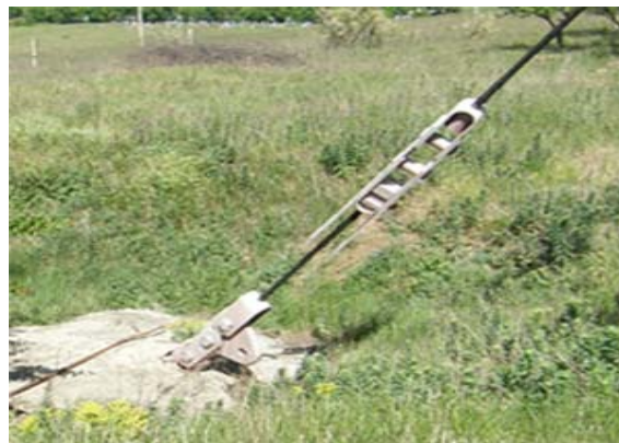
Рис. 1. Ділянка відтяжки щогли в м. Краматорськ
