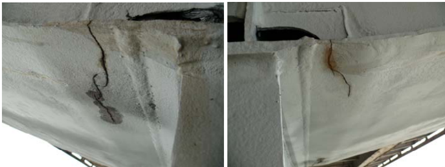
Рис. 3. Ослабленные коррозией нижние пояса несущих ригелей
