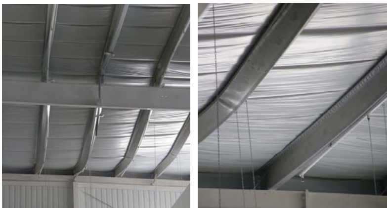
Рис. 1. Деформації конструкцій покриття під дією снігового навантаження
