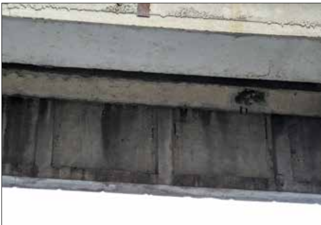
Рис. 13. Тріщини в бетоні бичка
