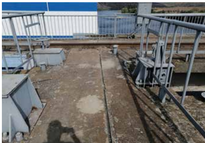
Рис. 5. Відсутня герметизація температурно-осадового шва
