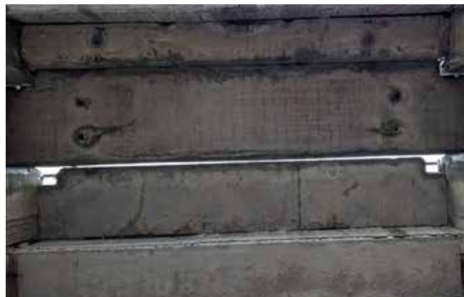
Рис. 4. Сліди затікання води, поверхнєве руйнування бетону залізобетонної плити
