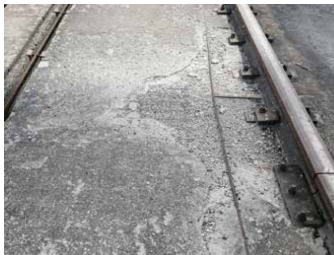
Рис. 10. Вищерблення верхнього шару набетонки з оголенням арматури
