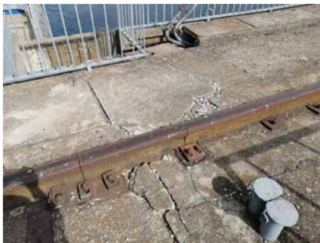
Рис. 9. Руйнування набетонки водозливної греблі
