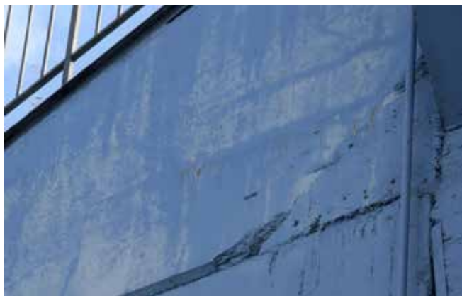
Рис. 16. Відкол бетону облицювальної панелі з оголенням арматури
