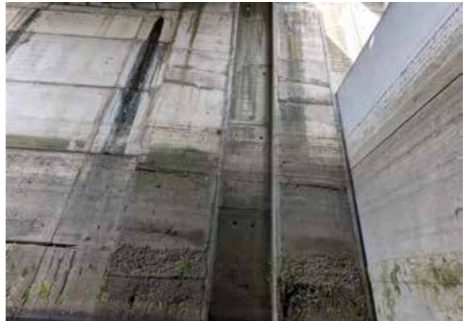
Рис. 12. Руйнування бетону бичка, сліди затікання води з вище розташованих конструкцій, вилугування цементно-піщаного розчину швів, відколи бетону облицювальних панелей з оголенням арматури
