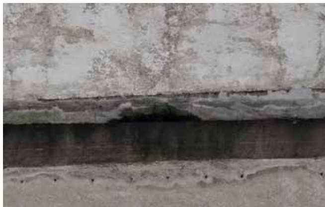
Рис. 3. Відколи бетону залізобетонної плити
