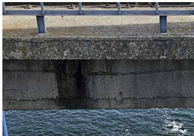
Рис. 6. Сліди затікання води, руйнування захисного шару бетону підкранової балки
