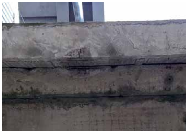
Рис. 7. Сліди затікання води на кабельному лотку, руйнування захисного шару бетону з оголенням арматури
