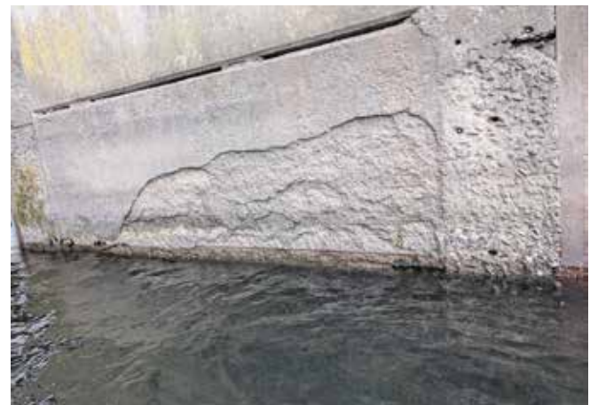
Рис. 14. Вилугування цементно-піщаного розчину швів, відкол бетону бичка, руйнування бетону облицювальної панелі з оголенням арматури
