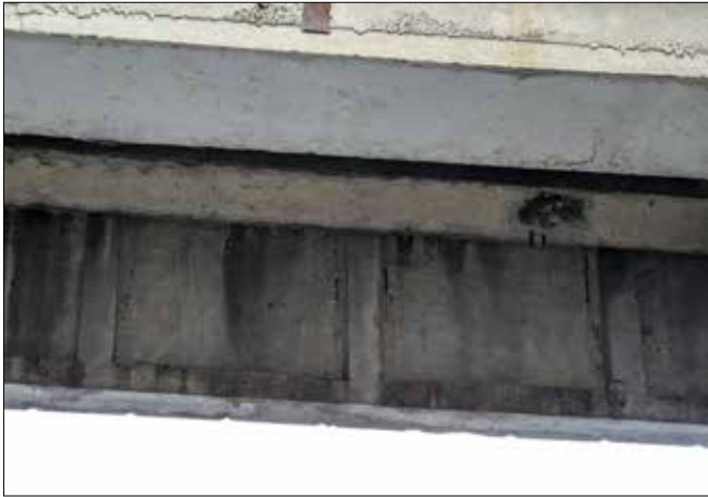
Рис. 11. Сліди затікання води, руйнування бетону з оголенням арматури декоративної панелі
