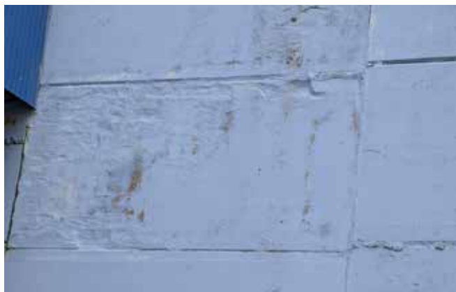
Рис. 15. Поверхнєве руйнування бетону облицювальних панелей стоянів, вилугування цементно-піщаного розчину швів
