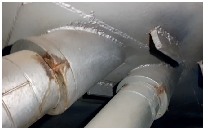
Рис. 3. Сліди іржі та протікання мастила в анкерах канатів вантів на залізобетонних прогонах
