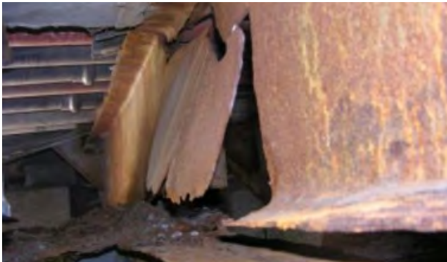
Руйнування поперечної балки на опорі № 1 мосту Патона
