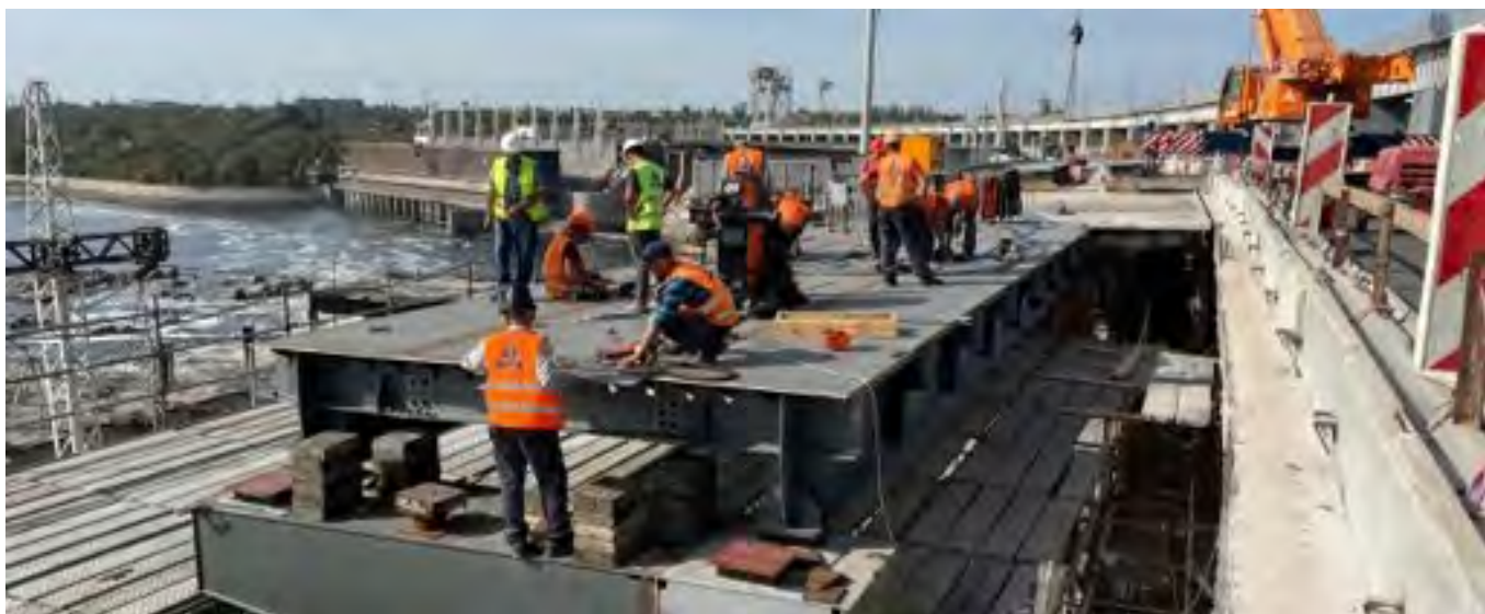
Автопроїзд греблею ДніпроГЕС. Технічний стан металоконструкцій після ракетного удару 22 березня 2024 р. і відновлювальні роботи
