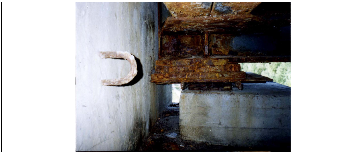
Рис. 2.10. Корозія та переміщення опорних частин сталезалізобетонної прогонової будови Московського моста
