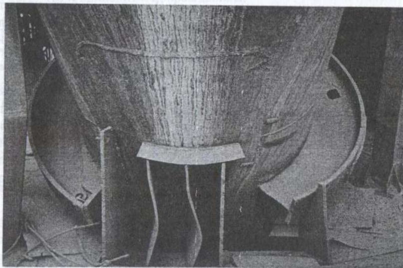
Рис. 16.2. Деформации опорных стульчиков при наклоне кожуха
