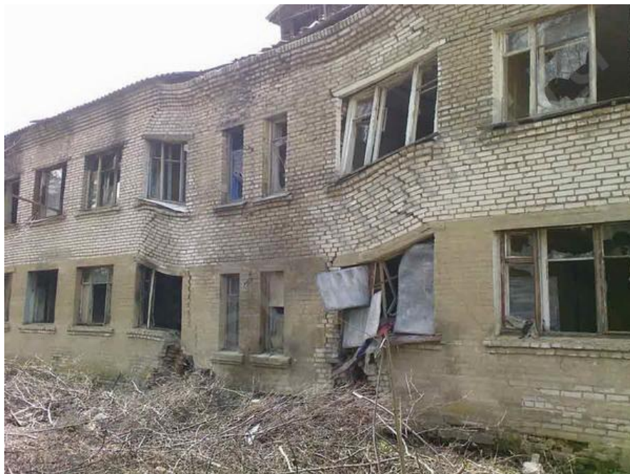
Рис. 2.4. Нерівномірне просідання основи
