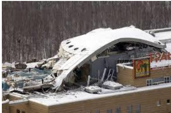
Рис. 3.8. Покриття «Трансвааль-Парку», що обвалилося
