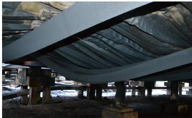
Рис. 4.27. Конструкції, що зазнали пожежі
