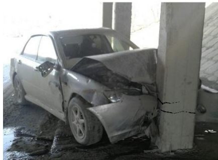
Рис. 3.4. Руйнування опорної конструкції при наїзді автомобіля
