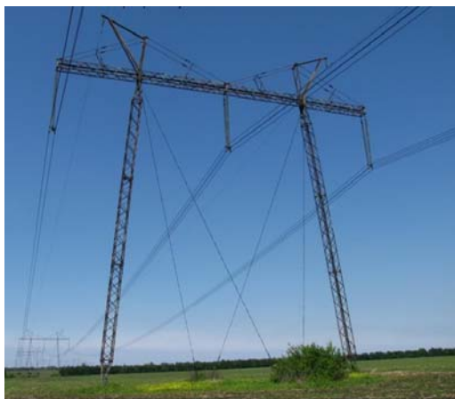
Рис. 6.32. Портальная опора на оттяжках
