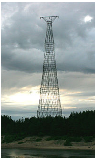
Рис. 6.36. Гиперболоидная опора перехода ЛЭП через Оку
