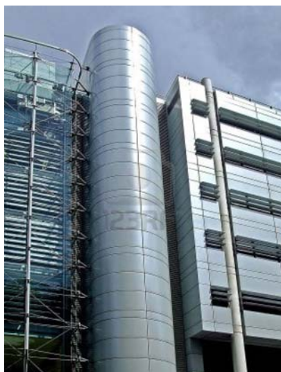
Рис. 6.21. Труба, прикрепленная к каркасу здания
