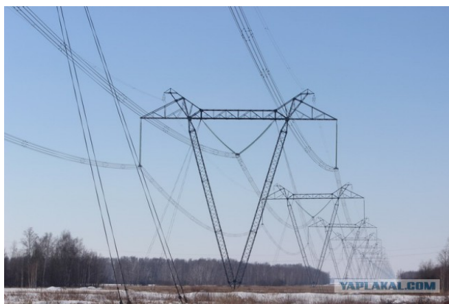
Рис. 6.23. Опоры ЛЭП Алтай-Экибастуз.
