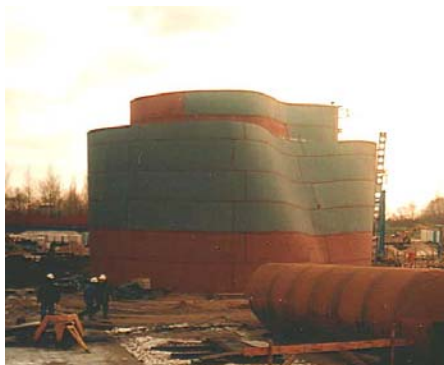
Рис. 8.25. Разрушение резервуара ветром
