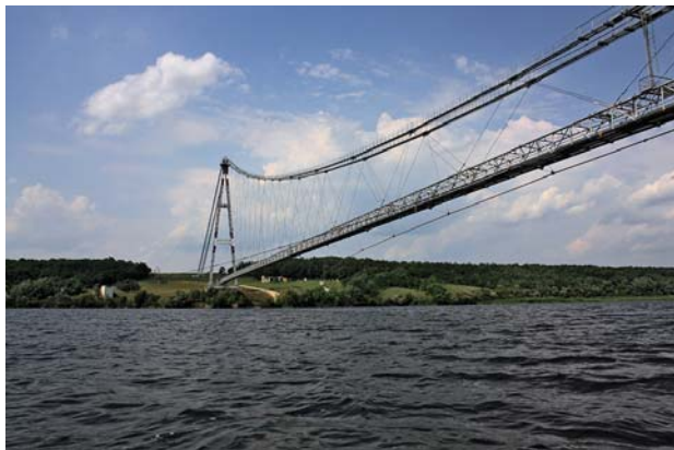
Рис. 3.40. Аммиакопроводный переход через Днепр
