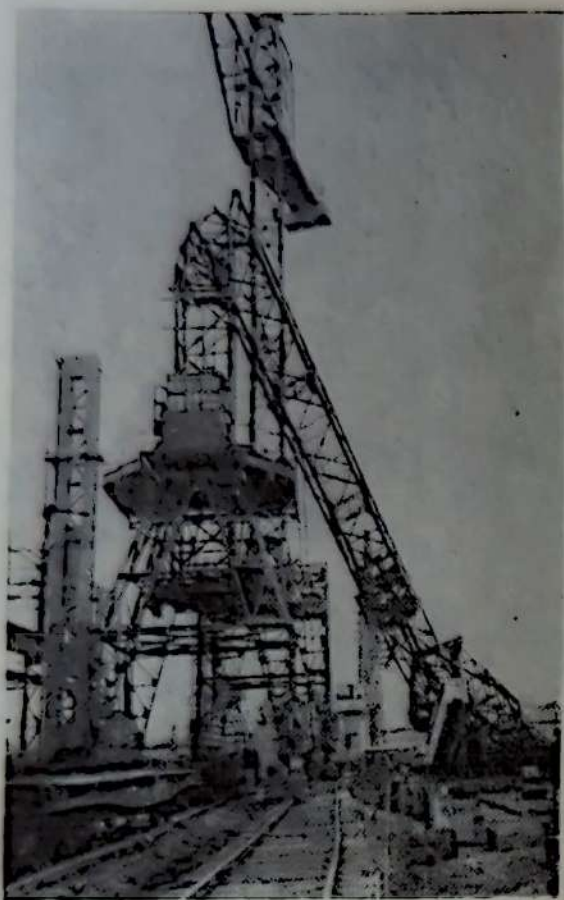
Рис. 50. Обрушение башенного крана на строительстве конверторного цеха.
