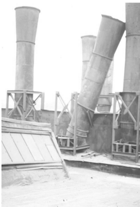
Рис. 1.22. Потеря несущей способности ствола газоотводной трубы в результате коррозионного износа
