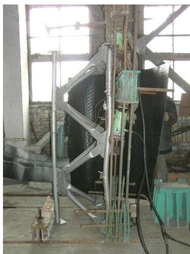
Рис. 5.31. Разрушение пространственно-стрелковой конструкции стойки
