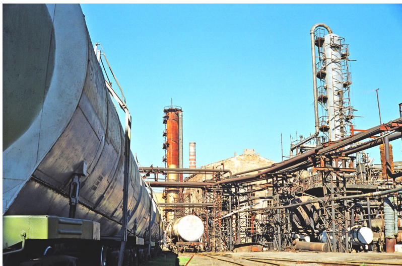
Рис. 1.14. Технологические трубопроводы и листовые конструкции коксохимического предприятия
