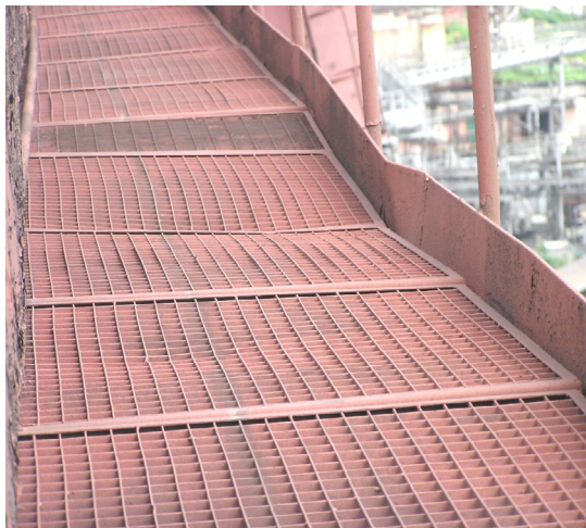
Рис. 3.16. Механические повреждения конструкций проходных трапов галерей
