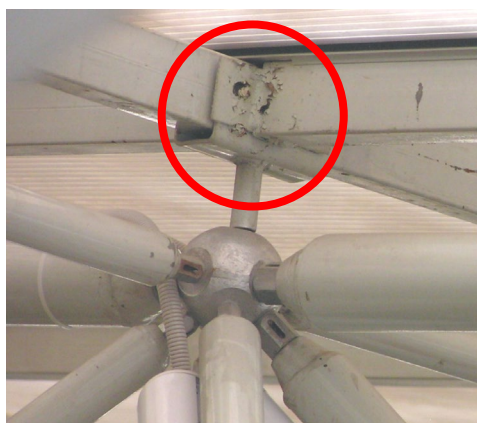
Рис. 6.13. Разрушение противокоррозионного защитного покрытия узловых элементов каркаса ограждения.
