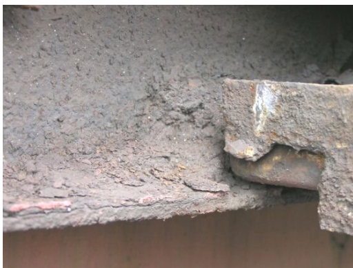
Рис. 3.18. Участок соединения опорного элемента и соединительного элемента опорного элемента на участке обрушения секции настила
