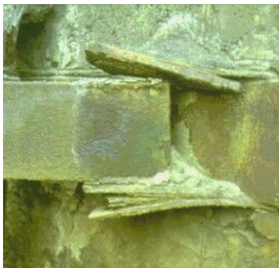
Рис. 1.24. Общая и местная (щелевая, подповерхностная, язвами) коррозия узлового соединения
