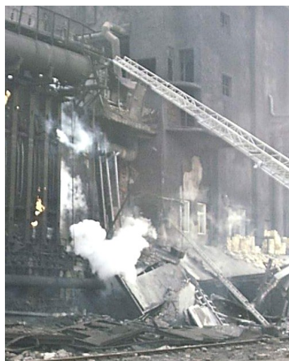
б – разрушение здания в результате взрыва, вызванного утечкой газа при коррозионно-механическом повреждении задвижки трубопровода
