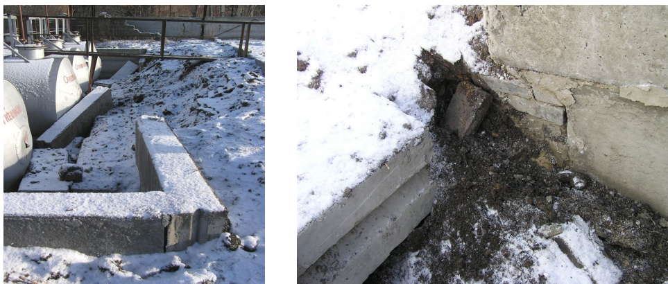
Рис.1.16. Обрушение подпорной стенки, повлекшее обрыв сливных патрубков емкостей для хранения ГСМ и утечку нефтепродуктов
