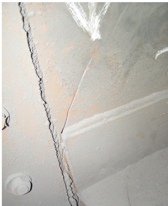
Рис. 2.2. Трещина в основном металле опорной фасонки стропильной фермы
