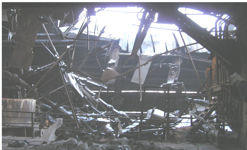
Рис. 1.15. Обрушение конструкций кровли мартеновского цеха
