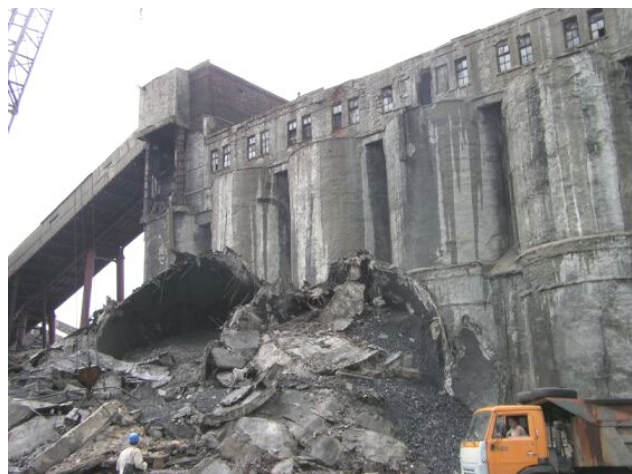
Рис. 1.19. Обрушение силосов в результате потери устойчивости положения
