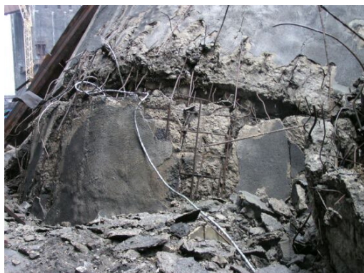
Рис. 1.20. Дефекты бетонирования и коррозионные поражения арматуры
