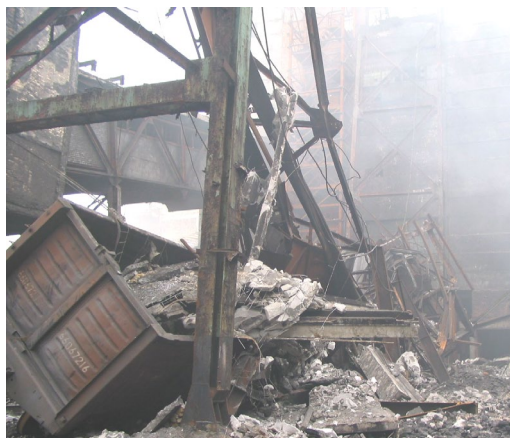
а – обрушение транспортной галереи вследствие коррозионного износа сечений металлоконструкций
