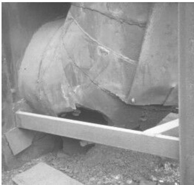
Рис. 1.23. Сквозное коррозионное разрушение торовой поверхности ствола
