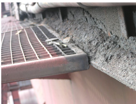
Рис. 3.17. Смещение ходового трапа с опорного элемента
