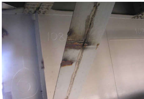
Рис. 4.7. Не видалені залишки монтажних елементів, антикорозійне покриття зруйноване, поверхнева корозія металу
