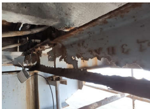
Рис. 6.7. Корозійне руйнування балкової клітки бази ліхтарної щогли
