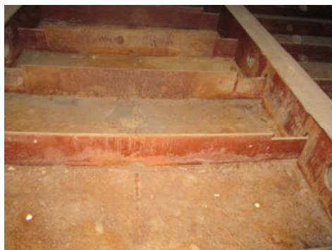
Рис. 1.43. Поверхова корозія стінки та ребер коробки головної балки біля крайніх опор естакади
