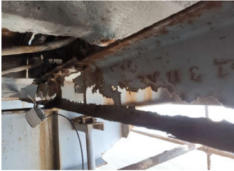
Рис. 5.9. Корозійне руйнування балкової клітки бази ліхтарної щогли
