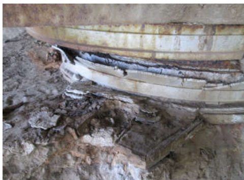
Рис. 1.46. Руйнування анкерних болтів, захисного кожуха та еластичного ущільнювача. Корозія елементів опорної частини
