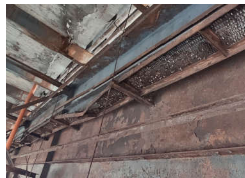
Рис. 5.6. Руйнування та деформація металоконструкцій оглядових проходів
