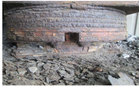
Рис. 4.33. Відсутній захисний кожух та мастило на поверхнях тертя. Корозія опорної частини
