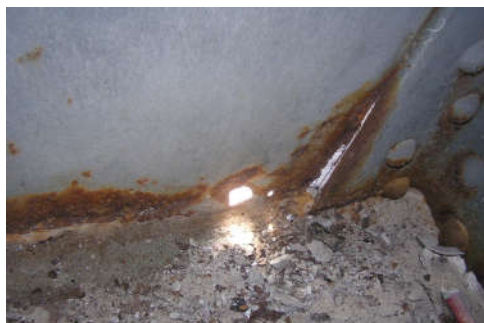
Рис. 11.4. Наскрізна корозія в стінці головної балки
