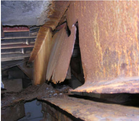
Рис. 3.3. Руйнування поперечної балки на опорі № 1
