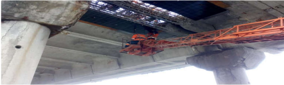
Рис. 2.4. Наслідки руйнування бетону в місцях влаштування деформаційних швів
