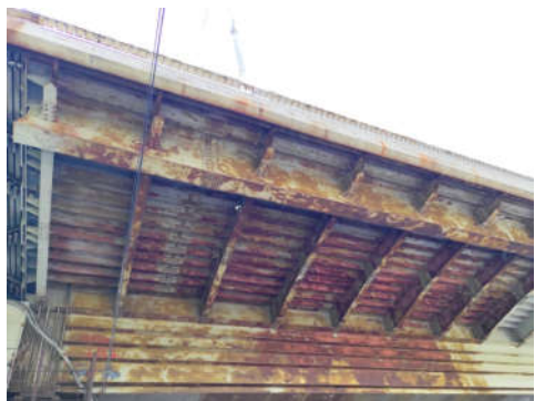
Рис. 3.5. Руйнування антикорозійного фарбового покриття поверхонь стінок та подовжніх ребер ззовні коробки балки жорсткості
