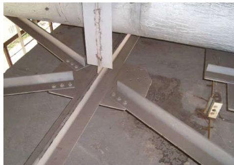
Рис. 4.6. Відсутній (демонтований) елемент горизонтальних в'язей по нижніх поясах прогонової будови
