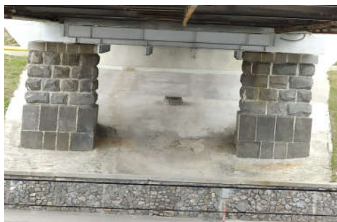
Рис. 11.11. Вилугування та замокання бетону на опорі № 6
