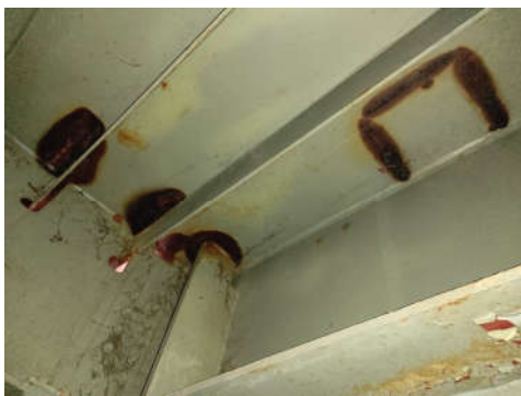
Рис. 3.6. Пошкодження антикорозійного покриття та поверхнева корозія ортотропної плити внаслідок термічної дії зварювання
