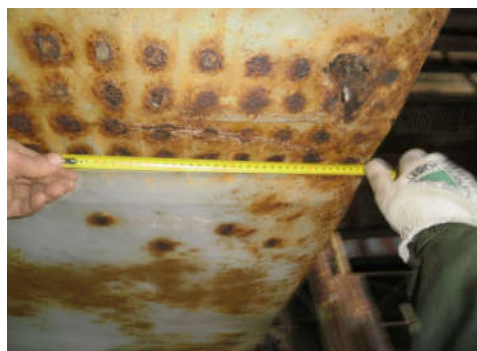
Рис. 1.15. Корозійна тріщина завдовжки ~ 450 мм у нижньому поясі ригеля на бичку № 3 зі сторони греблі
