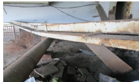
Рис. 4.31. Руйнування в'язі біля опори № 0
