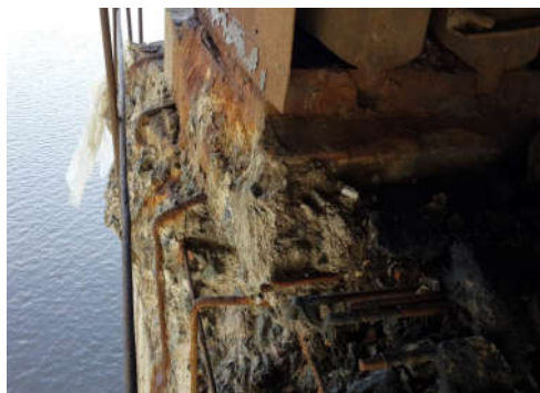
Рис. 5.4. Сколи бетону, оголення та корозія арматури підферменників опори № 11
