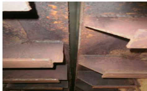
Рис. 4.37. Корозія опорних метало-конструкцій шва внаслідок відсутності антикорозійного захисту
