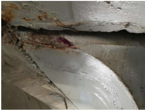
Рис. 12.6. Руйнування захисного шару бетону, корозія арматури
