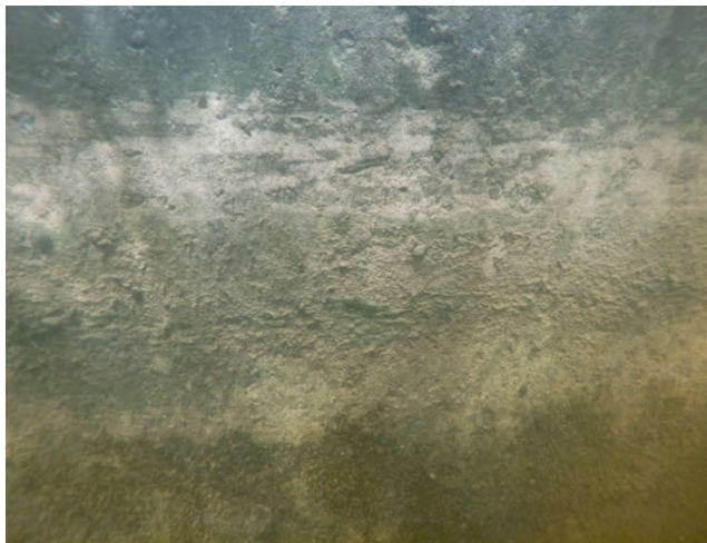
Рис. 3.8. Обростання біологічними організмами всієї поверхні підводної частини тіла та ростверку опори № 4. З низової сторони моста ростверк занурений у ґрунт, а з верхової сторони з лівого боку підмив ґрунту на глибину від 0,7 до 1,8 м
