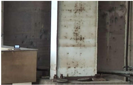
Рис. 4.32. Місцеві руйнування антикорозійного покриття колони
