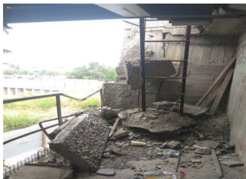
Рис. 1.50. Обвал облицювання на оглядову частину стояна, що призвів до деформації перил й ускладнив доступ до драбини
