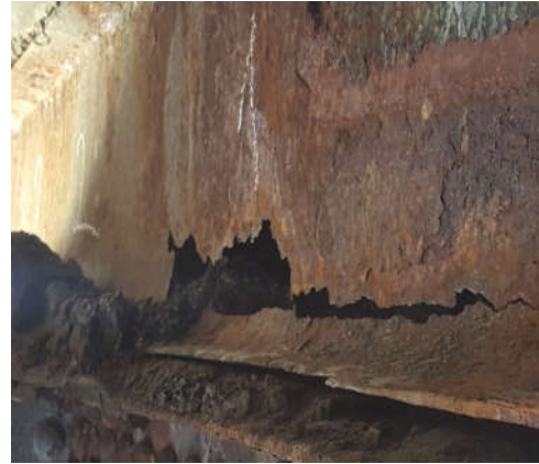
Рис. 3.4. Руйнування поперечної балки на опорі № 25
