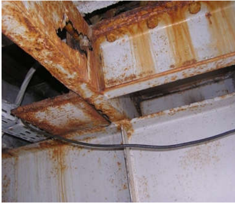
Рис. 4.9. Корозійне руйнування балкової клітки стовпа освітлення № 18
