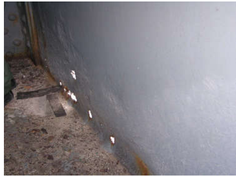
Рис. 9.4. Наскрізна корозія в стінці головної балки
