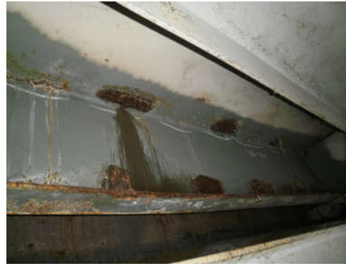
Рис. 1.12. Корозія металу ортотропної плити в місцях пропалення металу
