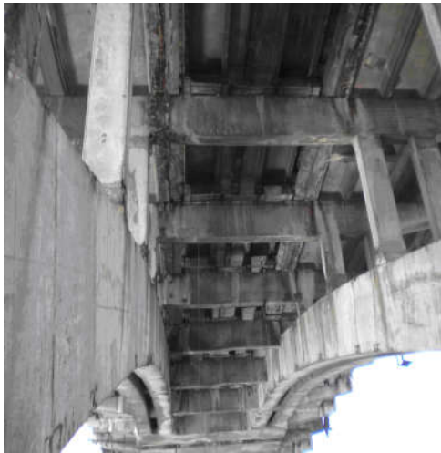
Рис. 5.4. Руйнування захисного шару монолітного бетону затижки з корозією попередньо напружених канатів
