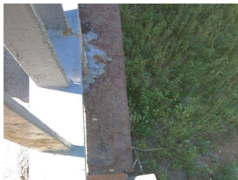
Рис. 1.41. Корозія металу кромки ортотропної плити
