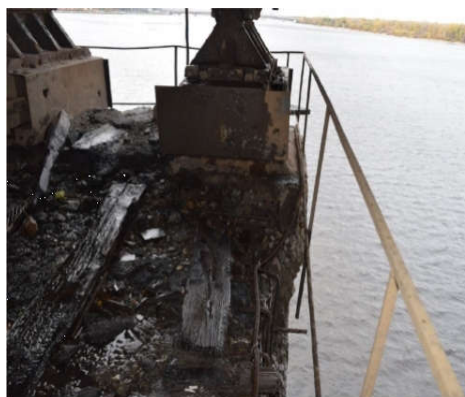
Рис. 4.5. Сколи бетону, оголення та корозія арматури підферменників опори № 11
