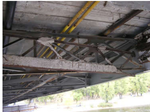
Рис. 9.6. Зруйнована в'язь балок протиага
