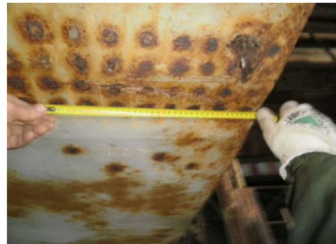
Рис. 1.22. Корозійна тріщина завдовжки ~ 450 мм у нижньому поясі ригеля на бичку № 3 зі сторони греблі
