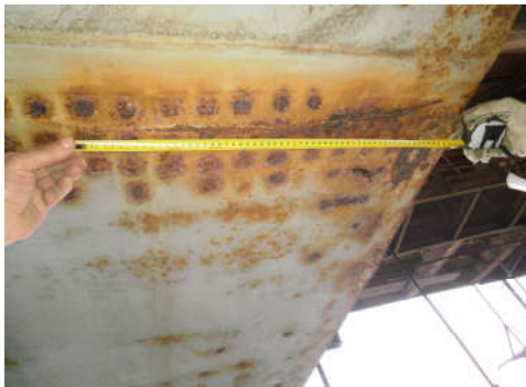
Рис. 1.21. Корозійна тріщина завдовжки ~ 650 мм у нижньому поясі ригеля на бичку № 3 зі сторони аванкамери
