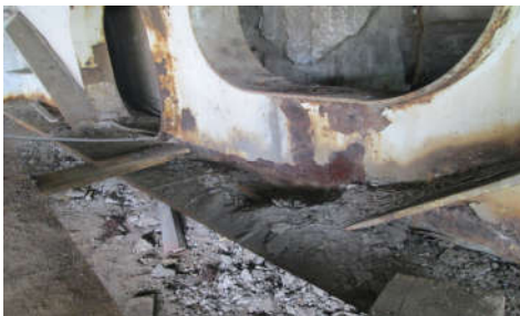
Рис. 4.30. Корозія опорної діафрагми на опорі № 0
