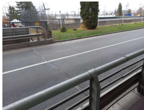
Рис. 12.9. Поперечні тріщини до 4 мм в асфальтобетонному покритті підходів до проїзної частини
