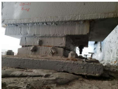
Рис. 12.4. Поверхнева корозія закладних деталей і опорних балансирів балки, зазори на місці бетонної підливки
