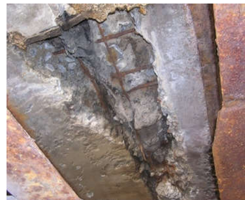
Рис. 4.8. Руйнування захисного шару бетону плити проїзної частини
