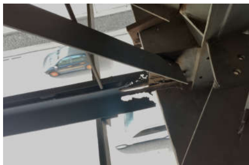
Рис. 11.3. Зруйнована корозією в'язь
