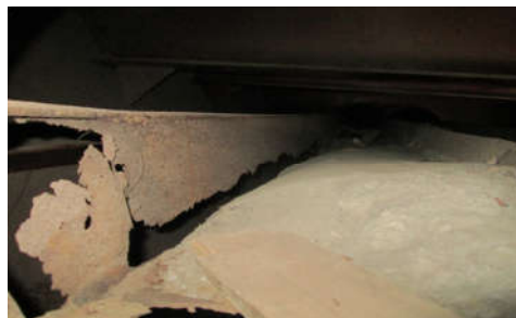
Рис. 4.39. Корозійне руйнування короба комунікацій
