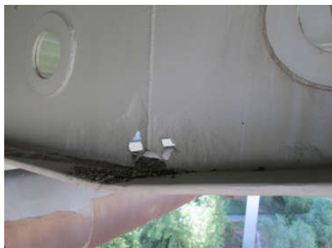
Рис. 1.42. Корозійні руйнування стінок окремих поперечних балок
