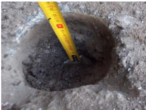
Рис. 12.8. Застій води під асфальтобетонним покриттям проїзної частини, зволоження нижнього шару
