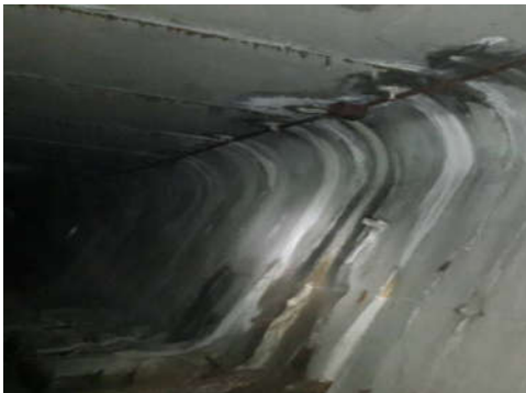
Рис. 2.5. Просочування води у залізобетонних прогонових будовах
