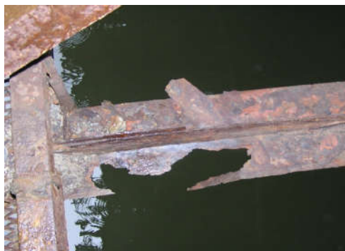
Рис. 5.5. Корозія горизонтальної в'язі більше 50% перерізу
