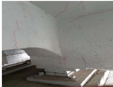
Рис. 12.7. Характерні тріщини з шириною розкриття 0,1 – 0,3 мм у діафрагмах, ребрах і полицях балок
