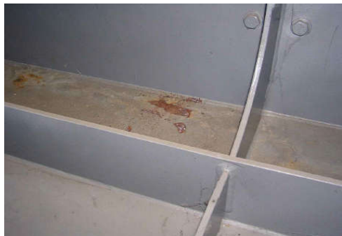
Рис. 4.5. Корозія нижнього поясу балки
