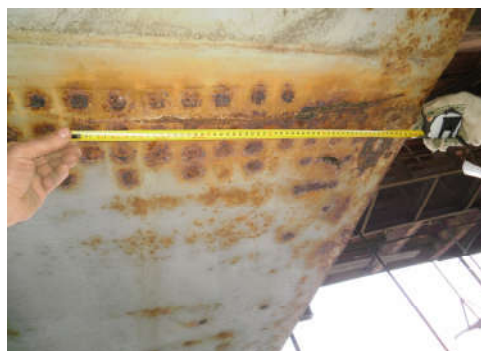
Рис. 1.14. Корозійна тріщина завдовжки ~ 650 мм у нижньому поясі ригеля на бичку № 3 зі сторони аванкамери
