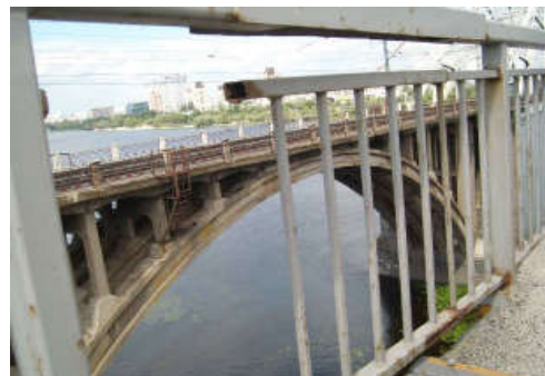
Рис. 4.12. Відсутнє заповнення перил у місці розташування деформаційного шва
