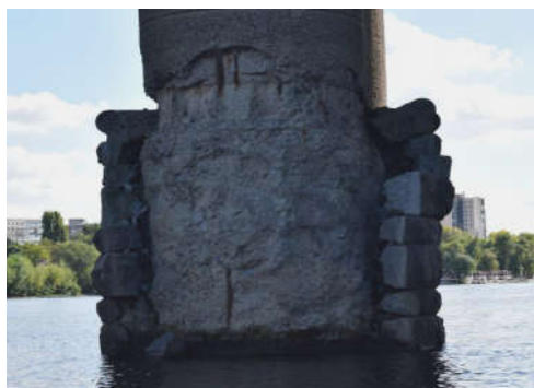
Рис. 6.1. Вивали фрагментів кам'яної кладки опори № 21
