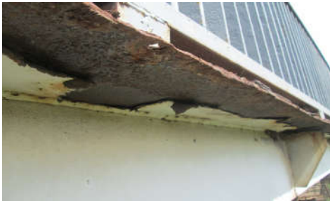
Рис. 4.28. Корозія металу кромки ортотропної плити
