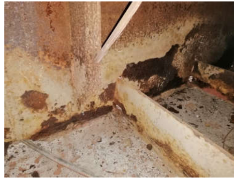
Рис. 3.10. Корозія опорної діафрагми та поздовжніх ребер на опорі № 6
