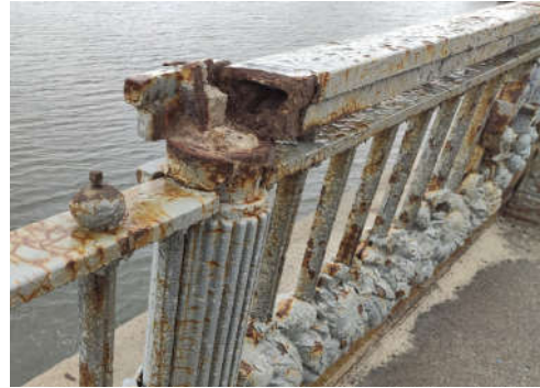
Рис. 5.10. Руйнування перильної огорожі
