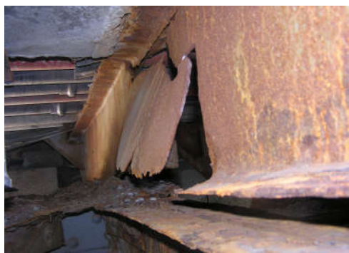
Рис. 6.9. Руйнування поперечної балки на опорі № 1
