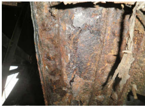
Рис. 1.30. Корозія опорної ділянки головної балки з ослабленням перерізу стінки
