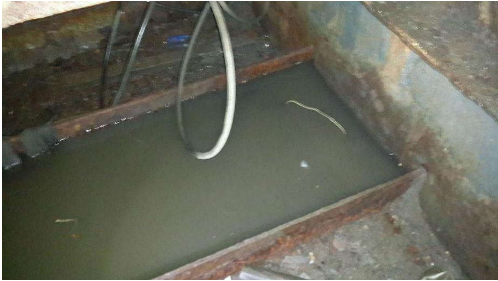
Рис. 6.2. Застій води, що потрапляє крізь деформаційний шов на нижній пояс коробчастої балки, призводячи до корозії металу
