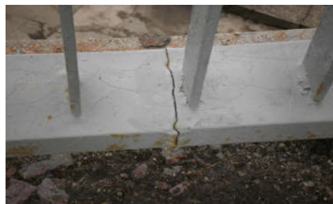
Рис. 4.35. Ушкодження лакофарбового покриття, тріщина в нижньому елементі перил
