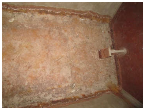
Рис. 1.45. Поверхова корозія верхівки колони. Антикорозійний захист зруйновано
