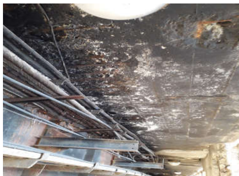
Рис. 1.34. Відшарування захисного шару бетону, сколювання, оголення та корозія арматури залізобетонної плити проїзної частини
