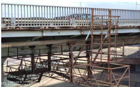
Рис. 4.38. Корозія елементів пересувних візків. Дощатий настил зруйнований. Механізми (редуктори) для пересування візків не працюють
