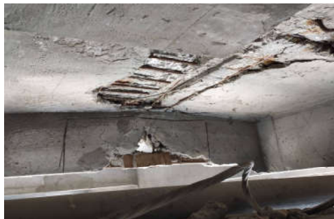
Рис. 11.7. Руйнування захисного шару бетону залізобетонної плити. Арматура оголена та кородує
