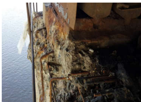
Рис. 6.2. Сколи бетону, оголення та корозія арматури підферменників опори № 11
