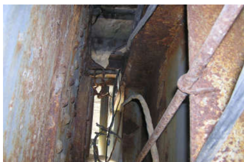
Рис. 11.5. Виразкова корозія балки противаги біля опори № 6
