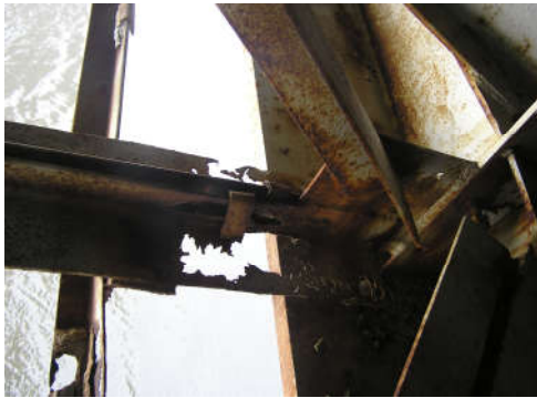
Рис. 9.3. Майже повністю зруйнована корозією в'язь
