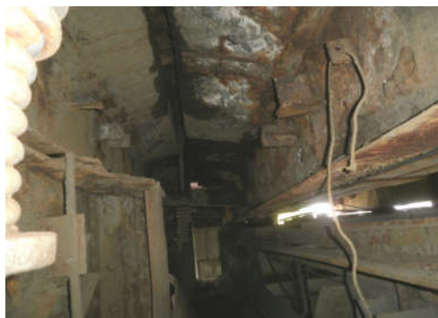
Рис. 6.5. Пружини та упори деформаційного шва зруйновані корозією
