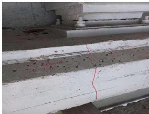
Рис. 12.5. Вертикальна тріщина в монолітному залізобетонному ригелі
