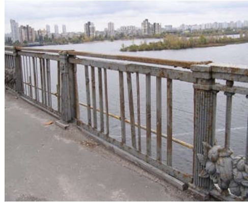
Рис. 4.10. Руйнування секції перильної огорожі та її кріплення, відрив декоративних елементів
