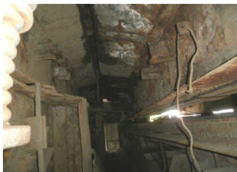
Рис. 5.7. Пружини та упори деформацийного шва, зруйновані корозією
