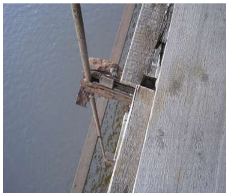
Рис. 4.7. Корозія металу несних елементів оглядових проходів
