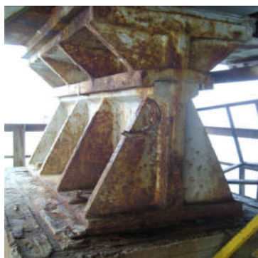
Рис. 9.14. Корозія елементів опорної частини
