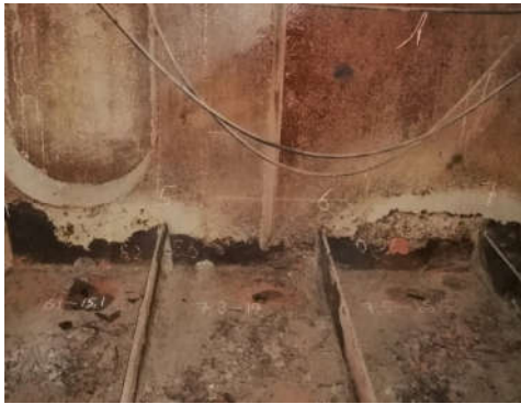
Рис. 3.9. Корозія опорної діафрагми на опорі № 0
