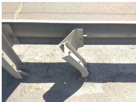
Рис. 1.47. Деформація стояка бар'єрної огорожі
