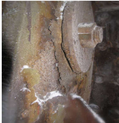
Рис. 5.5. Корозія конструкцій шарніра
