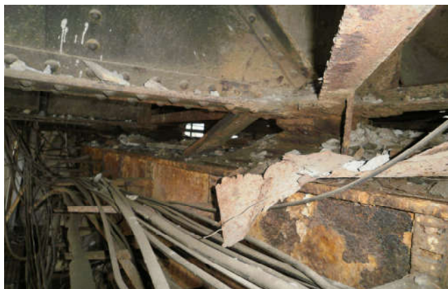
Рис. 1.13. Бруд, сміття на поверхні ригелів, купа непотрібних кабелів, іржаві кронштейни та місця їх кріплення до ригеля на бичку № 3
