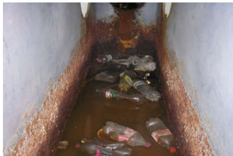
Рис. 11.10. Корозія металоконструкцій, сміття та накопичення атмосферної води в домкратній балці пілона на опорі №4
