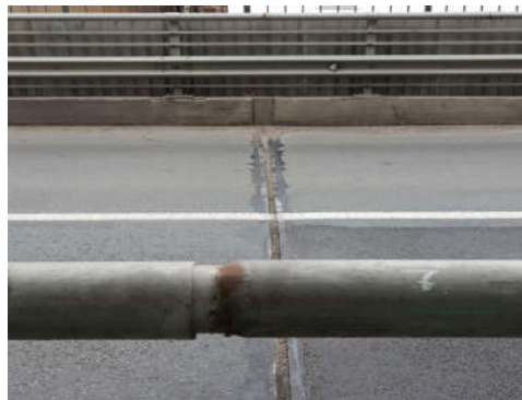
Рис. 12.11. Часткова корозія елементів бар'єрної огорожі
