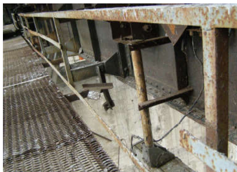
Рис. 1.36. Корозія, відсутні стійки та заповнення перильної огорожі
