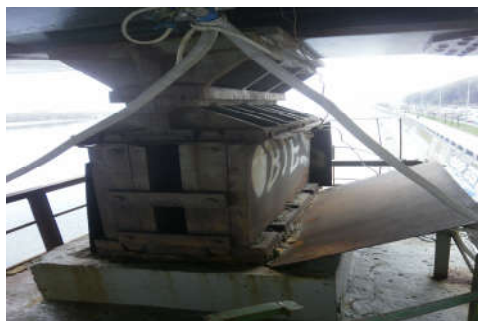
Рис. 11.12. Корозія елементів опорної частини, відсутні захисні кожухи
