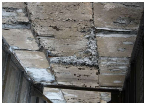
Рис. 1.33. Зменшення перерізу, тріщини, ніздрюватість, сколювання захисного шару бетону залізобетонної плити проїзної частини
