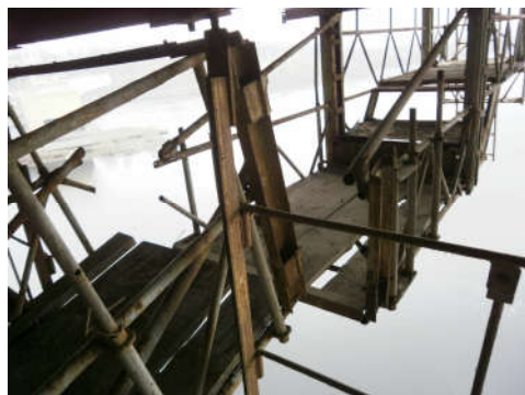
Рис. 1.19. Корозія несних елементів візка; частково відсутній дощатий настил і елементи огорожі; механізми пересування візка заблоковані в результаті дії корозії
