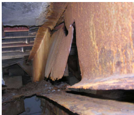
Рис. 4.3. Руйнування поперечної балки на опорі № 1
