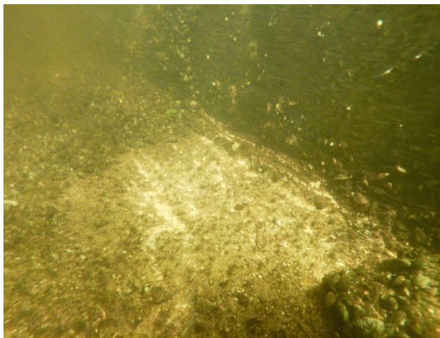
Рис. 3.9. Обростання біологічними організмами всієї поверхні підводної частини тіла та ростверку опори № 2. Підмиви ростверку з верхової сторони моста на глибину 1,2 – 1,4 м
