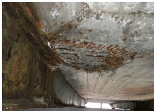
Рис. 6.6. Руйнування захисного шару бетону плити проїзної частини
