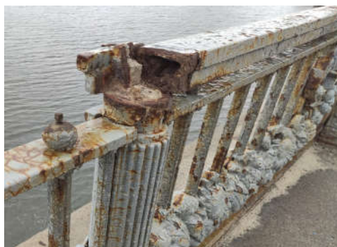
Рис. 6.8 Руйнування перильної огорожі
