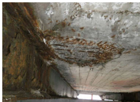
Рис. 5.8. Руйнування захисного шару бетону плити проїзної частини
