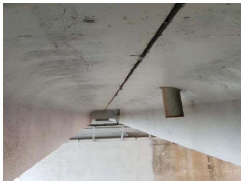
Рис. 12.10. Корозія сталевих труб водовідведення з проїзної частини, недостатня довжина труб водовідведення, яка є менше проєктної
