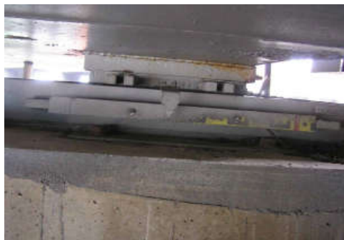
Рис. 4.8. Поверхнева корозія опорних плит опорної частини
