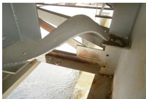
Рис. 11.6. Деформація та відрив фасонки балки противаги
