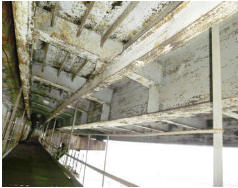
Рис. 1.11. Корозія конструкцій прогонової будови
