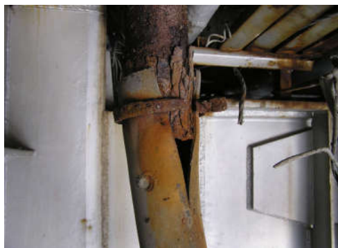
Рис. 9.11. Корозія водовідвідних труб
