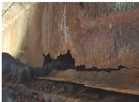
Рис. 6.10. Руйнування поперечної балки на опорі № 25
