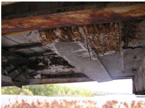
Рис. 9.7. Залізобетонні елементи протиага знаходяться під загрозою падіння
