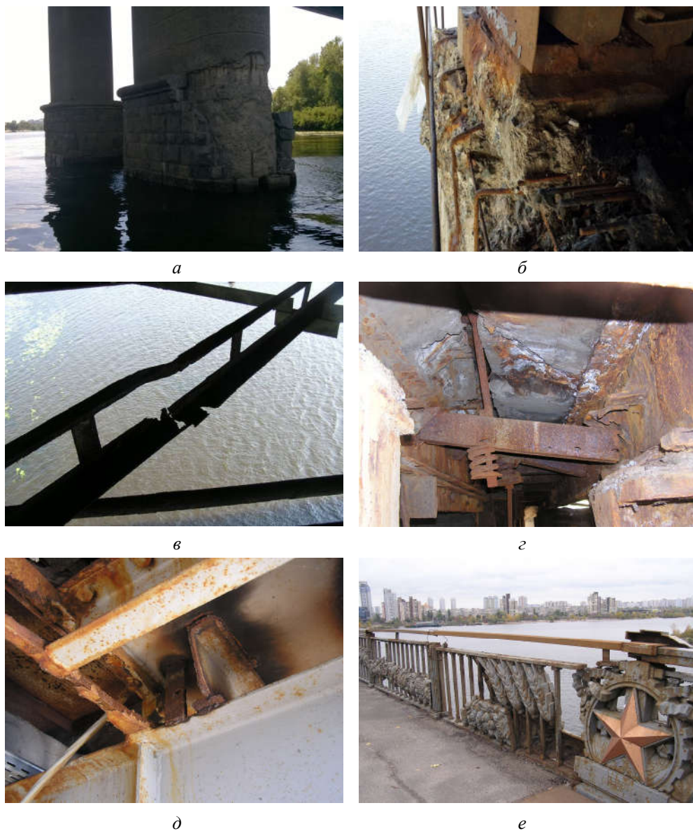
Рис. 2.5. Дефекти конструкцій моста ім. Є.О. Патона, які вимагають негайного усунення: a – вивали фрагментів кам'яної кладки опори № 21; б – часткове руйнування бетону ригеля опори № 11 під підферменником; в – корозійне руйнування горизонтальних в'язей у прогоні 16 – 17; г – корозія та руйнування елементів деформаційних швів та прилеглих поперечних балок; д – корозія та руйнування вузлів кріплення стовпів освітлення; е – руйнування секцій перильної огорожі та їх кріплень
