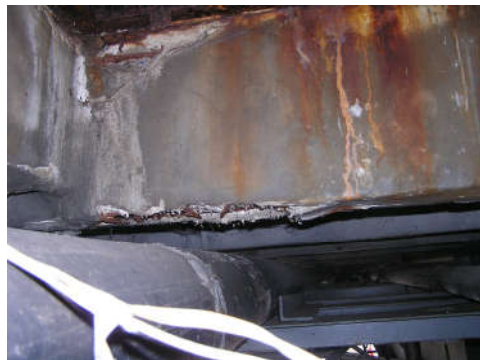
Рис. 9.8. Вивал захисного шару бетону в плиті пішохідної частини. Арматура оголена і кородує
