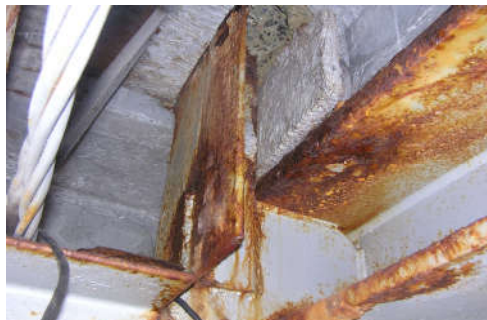
Рис. 11.9. Корозія підвіски у вузлі кріплення до прогонової будови
