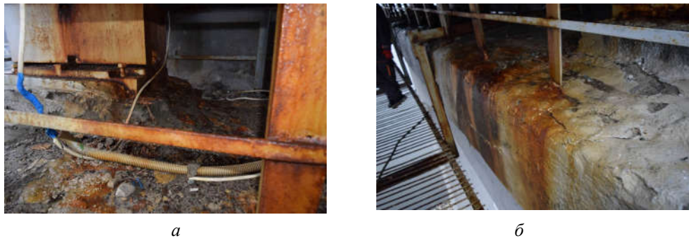
Рис. 8.4. Засміченість ригелів опор і пошкодження антикорозійного захисту опорних частин (а) і пошкодження бетону ригелів опор та їх захисного фарбового покриття (б)
