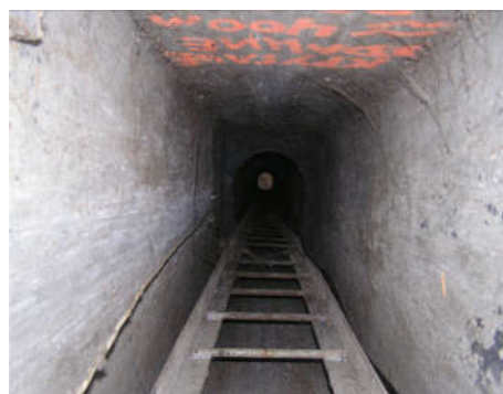
Рис. 9.10. Порушене антикорозійне покриття на внутрішній поверхні пілона
