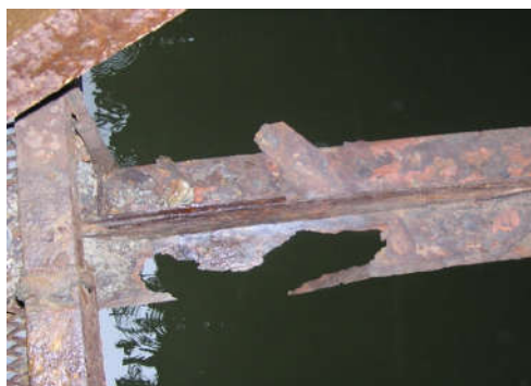
Рис. 6.3. Корозія горизонтальної в'язі більше 50% поперечного перерізу
