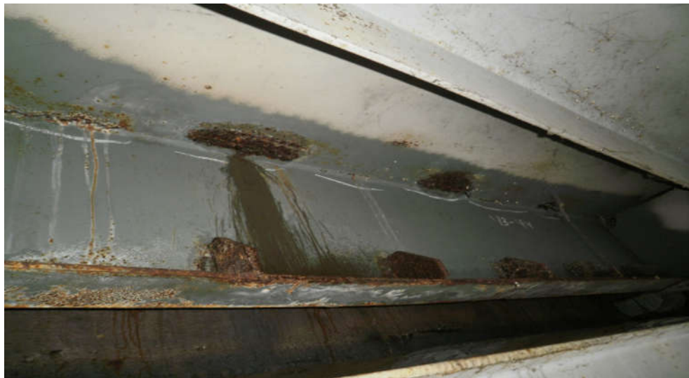
Рис. 4.15. Корозія металу ортотропної плити в місцях наскрізного пропалення металу
