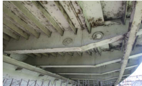
Рис. 4.29. Руйнування антикорозійного захисту ортотропної плити, подовжніх ребер і поперечних балок
