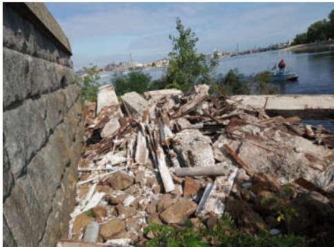
Рис. 9.5. Обвалені залізобетонні елементи протиага біля опори № 3
