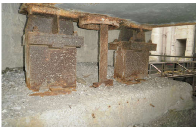
Рис. 1.16. Поверхнева корозія опорних частин ригелів. Відсутні захисні кожухи
