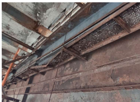
Рис. 6.4. Руйнування та деформація металоконструкцій оглядових проходів
