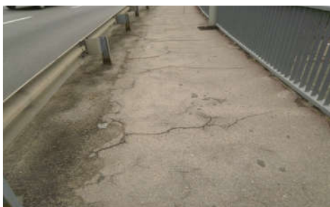
Рис. 4.34. Тріщини в тротуарному покритті, руйнування тротуарного покриття біля перил
