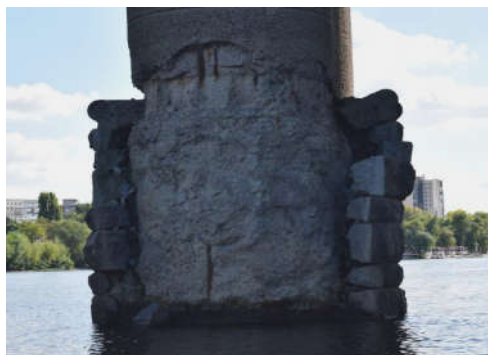
Рис. 5.3. Вивали фрагментів кам'яної кладки опори № 21
