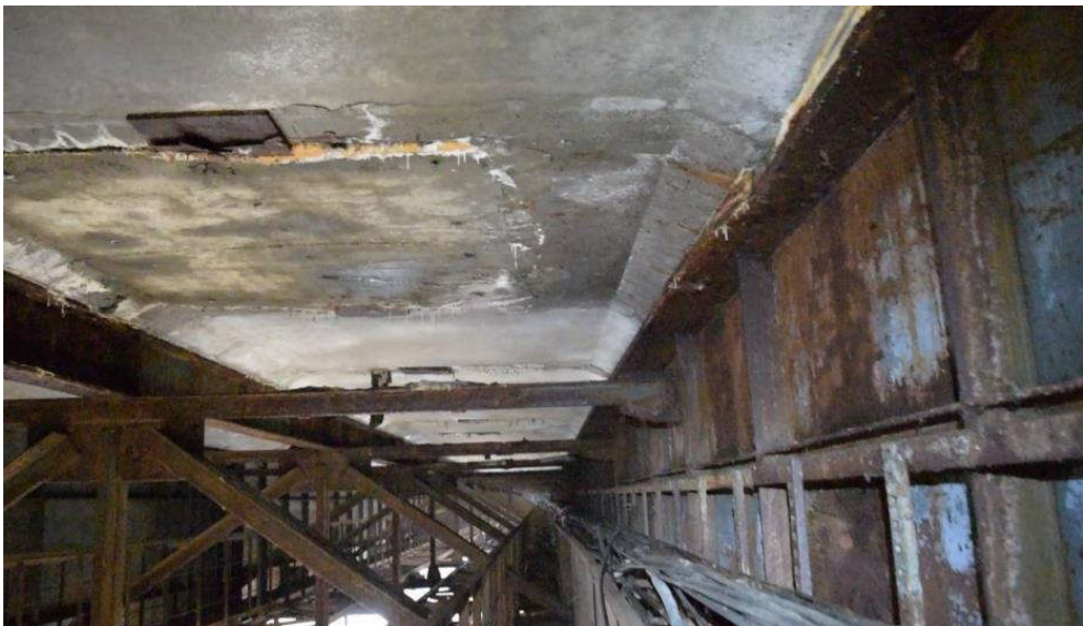
Рис. 6.3. Просочування води у сталезалізобетонних прогонових будовах
