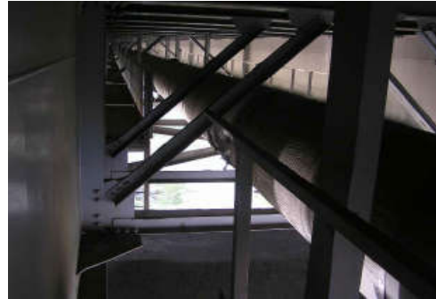
Рис. 4.10. Відсутні ділянки оглядових ходів
