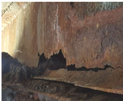
Рис. 4.4. Руйнування поперечної балки на опорі № 25
