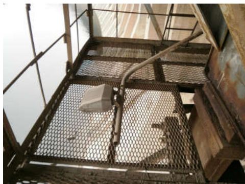
Рис. 1.18. Корозія елементів оглядових площадок
