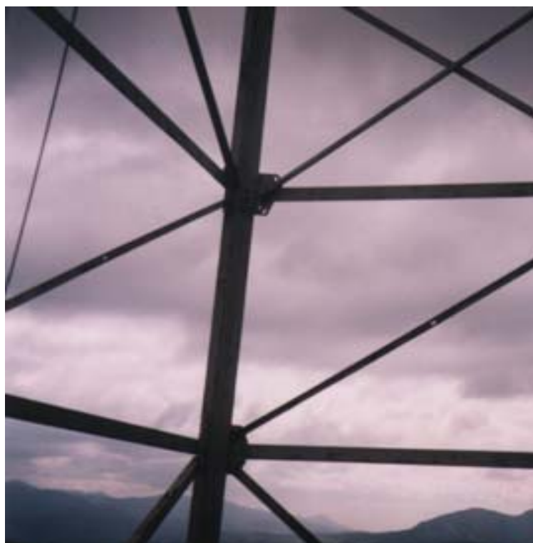
Рис. 10.7. Дефекты конструктивных элементов решетки башни
