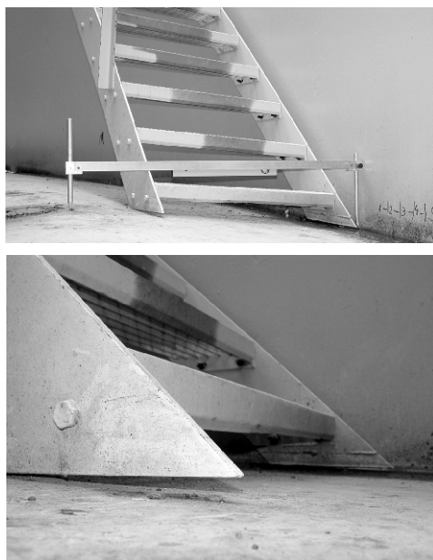
Рис. 4. Оторванная от дна лестница на предохранительной стенке резервуара
