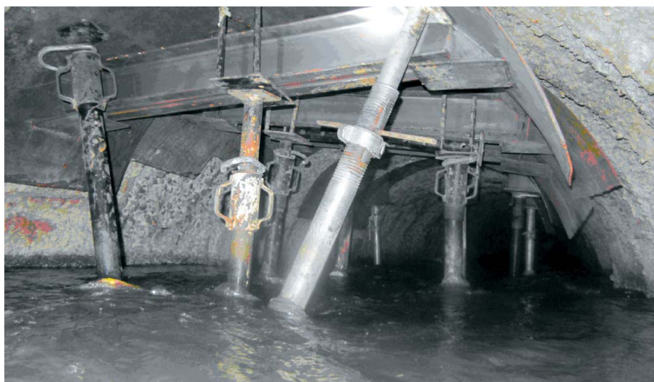
Рис. 14. Состояние конструкций тоннельного коллектора
